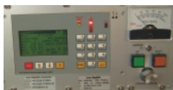
interne Temperaturregelung THERMCON
