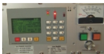
interne Temperaturregelung THERMCON
